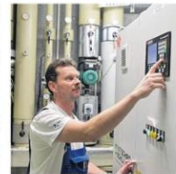
Techniker André Herklotz fährt das Blockheizkraftwerk im Freiburger Johannisbad langsam hoch.
