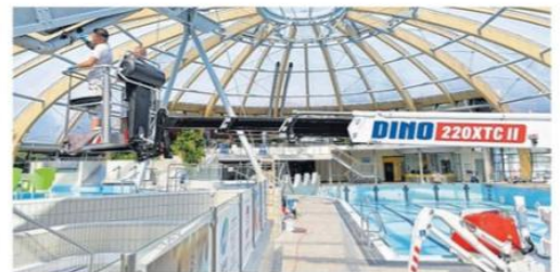
Mitarbeiter der Firma Hofmann aus Weigmannsdorf sind mit Malerarbeiten an der Rutsche im Innenbereich des Bades beschäftigt.
