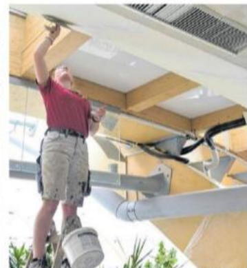
Ronja Schanz, Maler-Auszubildende im 3. Lehrjahr bei der Firma Maier Hofmann, bei Reparaturarbeiten in der Badehalle. FOTO: ECKARDT MILDNER
